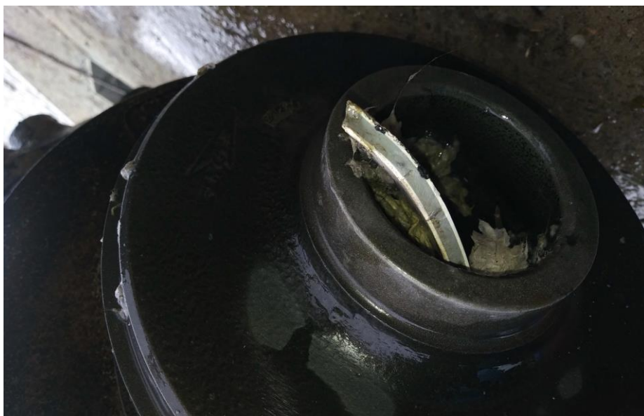
Débris de plastique obstruant une des pompes de notre poste de pompage
